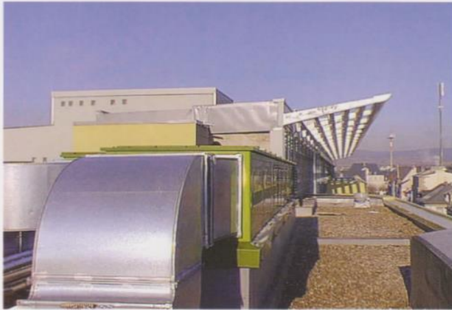
Die Zentrallüftungsanlagen wurden an die gebäudespezifischen Besonderheiten angepaßt.
