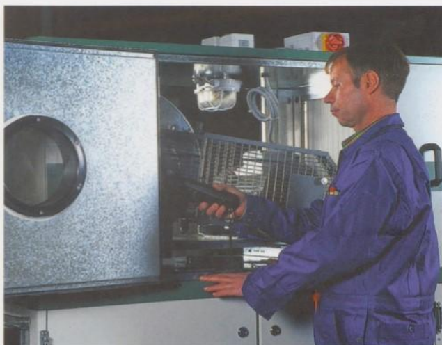
Auch bei Fensterlüftung treten Sick-Building-Syndrome auf. In zentral belüfteten Räumen steigt die Anzahl der Beschwerden bei mangelhafter Wartung und Instandhaltung der RLTA-Anlagen.
